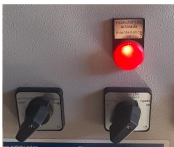
Seccionadores en posición OFF. Selectors in OFF position.
